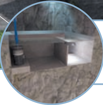
Главная дренажная насосная станция
