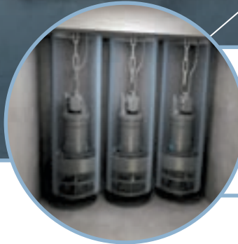
Заборная станция сырой воды
