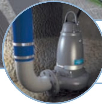
Перекачка зловонных жидкостей/ила на перерабатывающей установке
